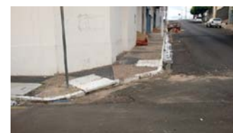
Fig. 16 Quadra 27- Inexistência de rebaixamento de guia
