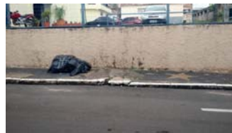
Fig. 4 Quadra 29: Estado de conservação da calçada
